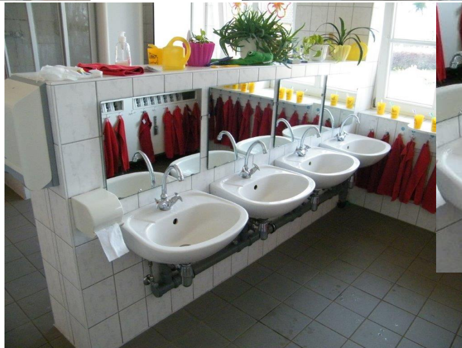
sanitären Einrichtungen Kita Cobbel
